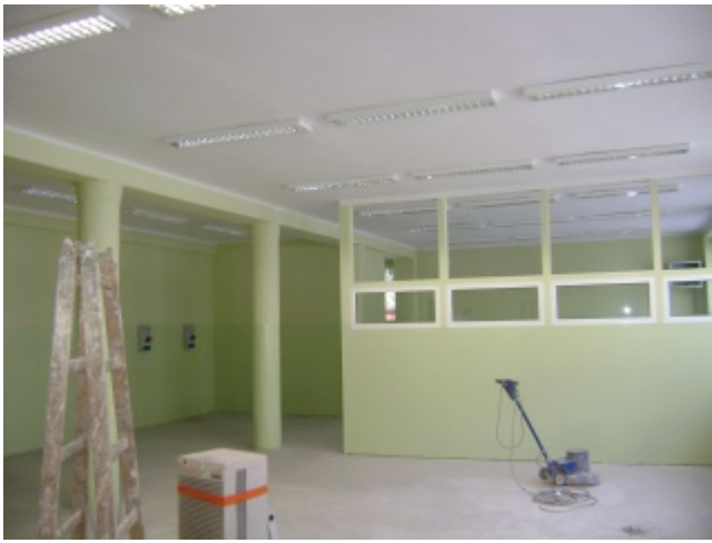
Pracownia automatyki w CKZiU2
